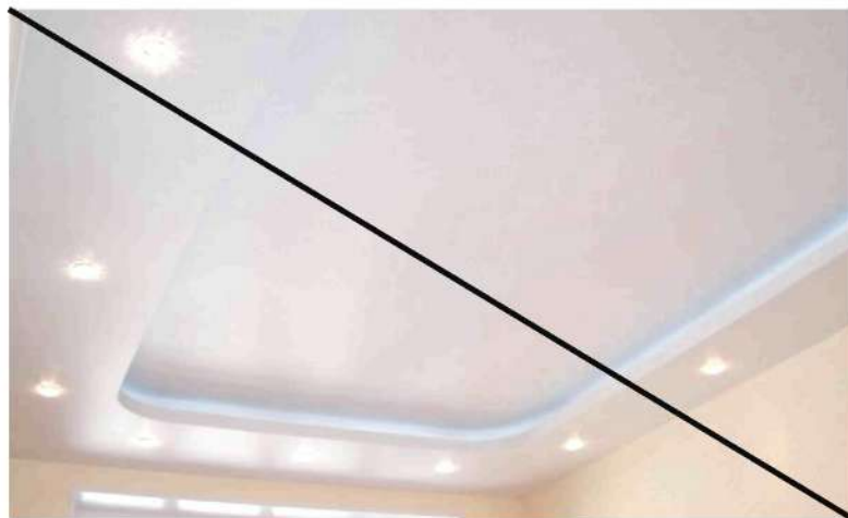
Плохо Многоуровневые гипсокартонные конструкции
