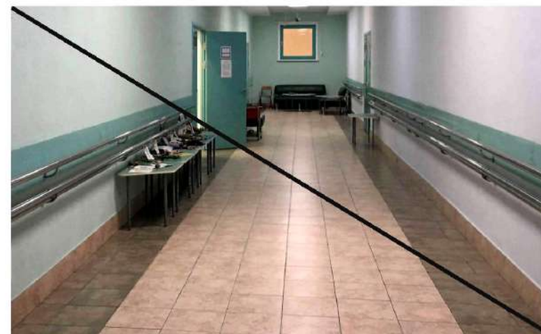
Плохо Керамогранитная плитка с крупными швами
