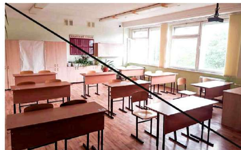
Плохо Линолеум под дерево
